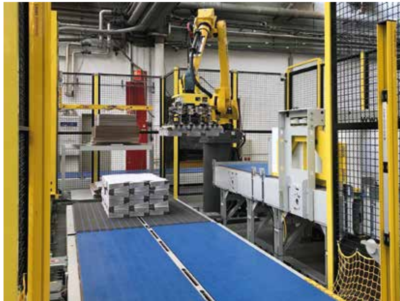
Zu den Investitionen gehört auch eine Palettieranlage mit Knickarmroboter mit flexiblen Greifsystem
